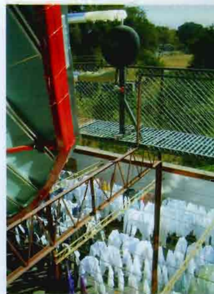
Vista de la empresa de lavandería Gajaraj Cleaners durante la fase de instalación de reflectores solares para generación de vapor en el terrado del edificio. El dispositivo receptor funciona por termosifón recirculando el agua presurizada hasta el tanque central de almacenamiento desde el que se canalizan las demandas de vapor de la maquinaria situada en la planta inferior.
