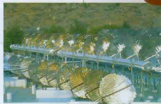
Instalación de 84 reflectores solares Scheffler en Abu Road (Rajasthan - India) que generan vapor solar para 15.000 comensales diarios
